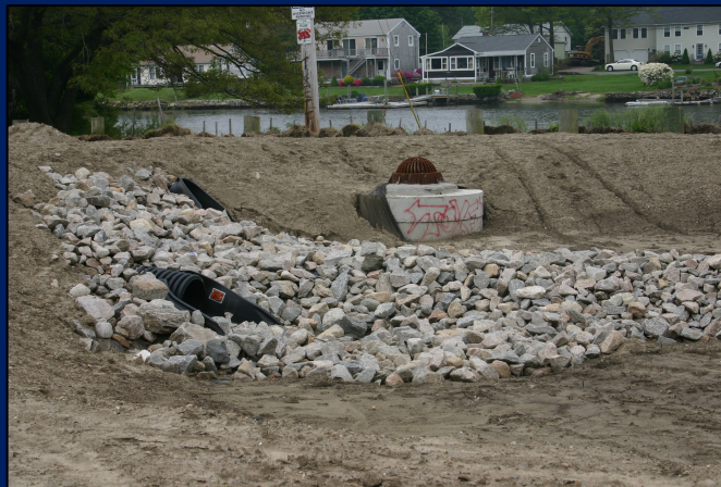
Mettatuxet Detention Pond 2006
